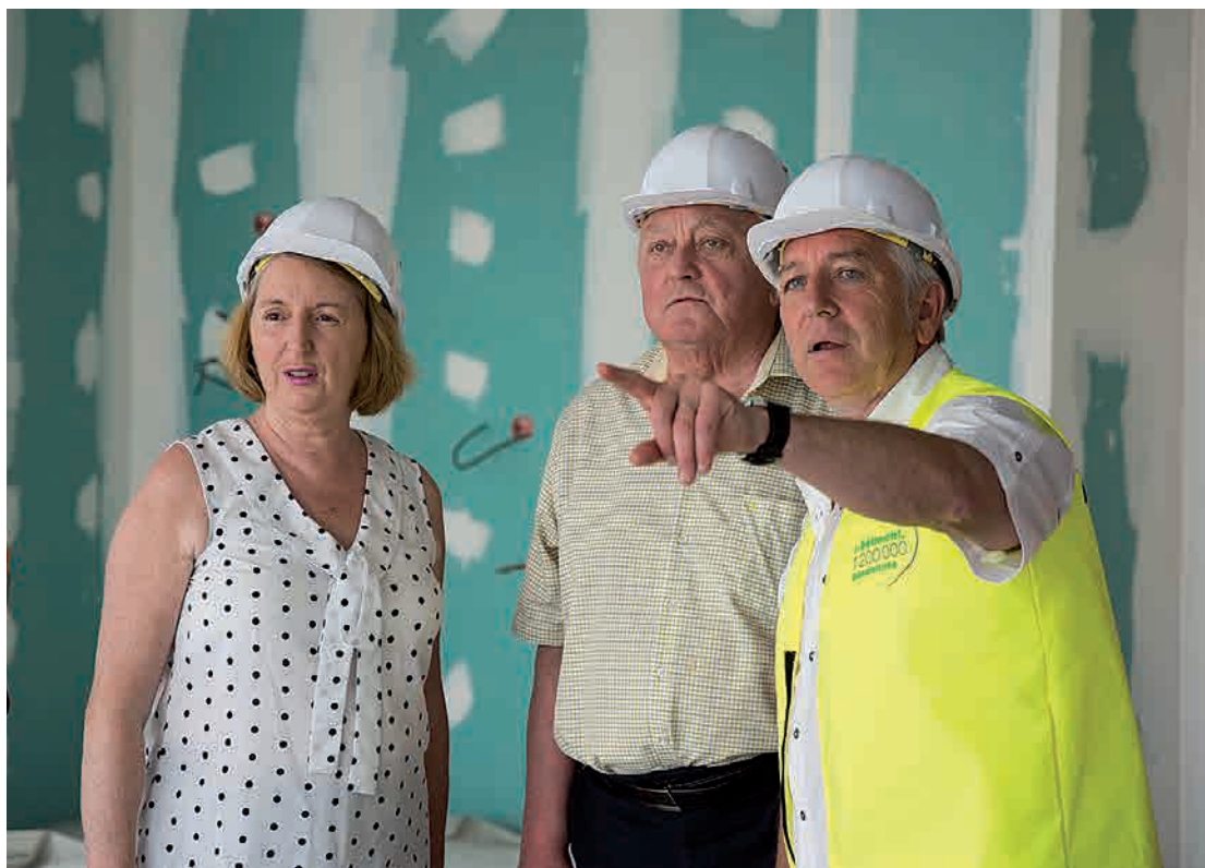
Mme Patricia Rousseau et M. Daniel Maciejasz, conseillers départementaux lors de la visite du chantier
